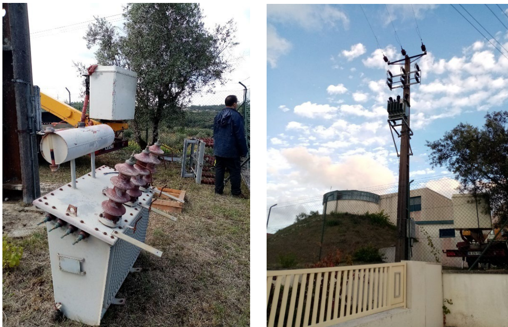
Imagem 47: Transformador antigo (esq.) e o novo (dir.)
