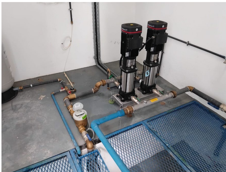
Imagem 46: Equipamento eletrobomba instalado
